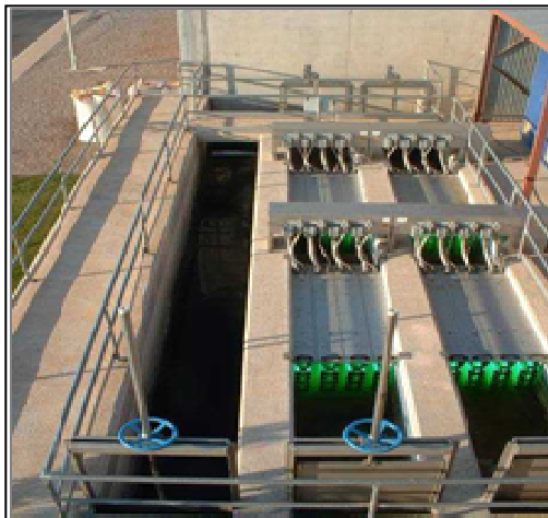
Instalación actual UV tradicional
